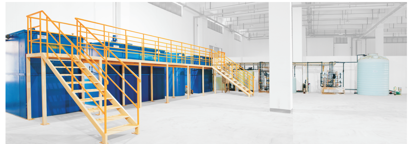
MBR、超滤膜车间
